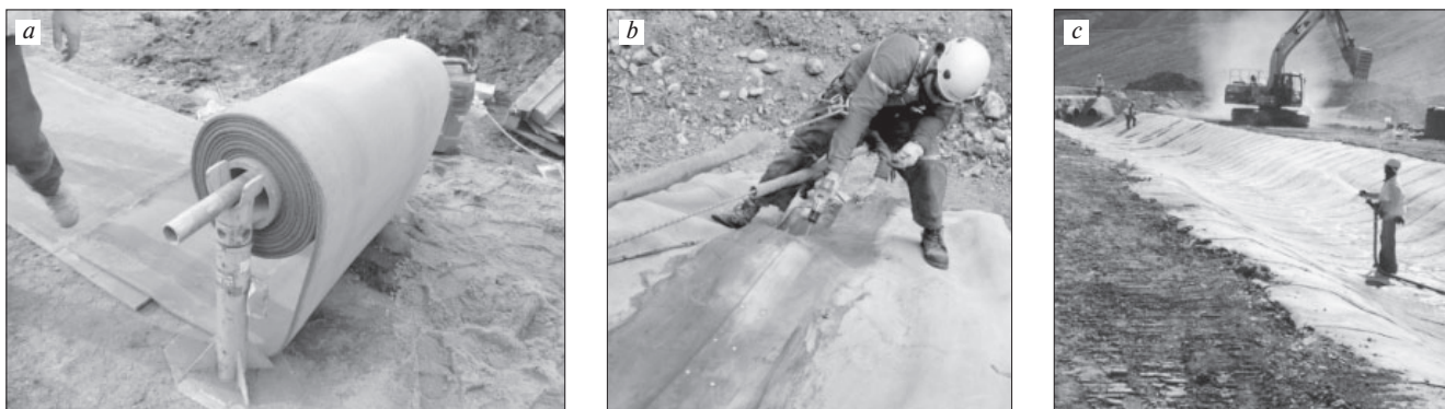
Рис. 2. Основные этапы укладки бетонного полотна: а – размотка рулона; б – фиксация полотен; в – смачивание бетонного полотна Fig. 2. The main stages of laying the concrete canvas: a – unwinding the roll; b – fixing the canvases; c – wetting of the concrete canvas
